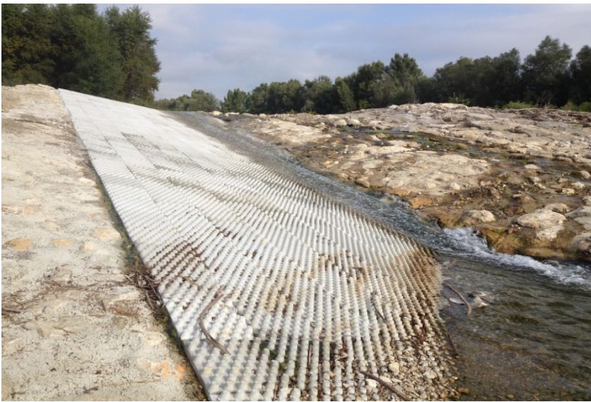
Passé à poissons après réception
